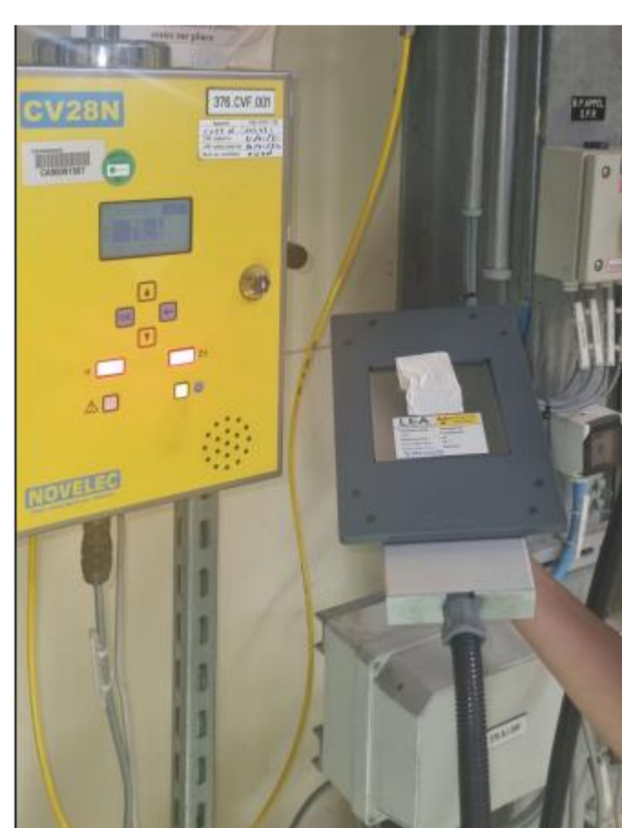
VPE sur un CV28 Equipe SPR installation
