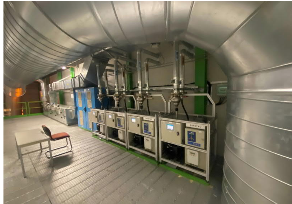
Surveillance extraction d'air Experience _Atlas
