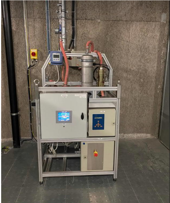
Surveillance extraction d'air Tunnel LHC5
